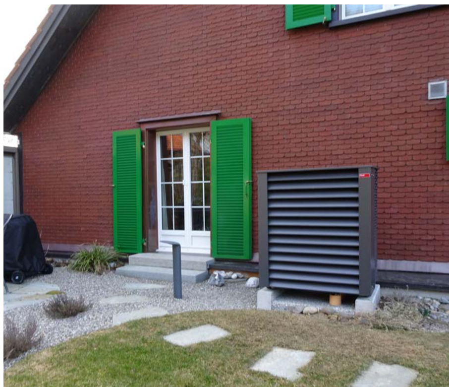
Luft/Wasser-Wärmeeinheit aussen und innen
